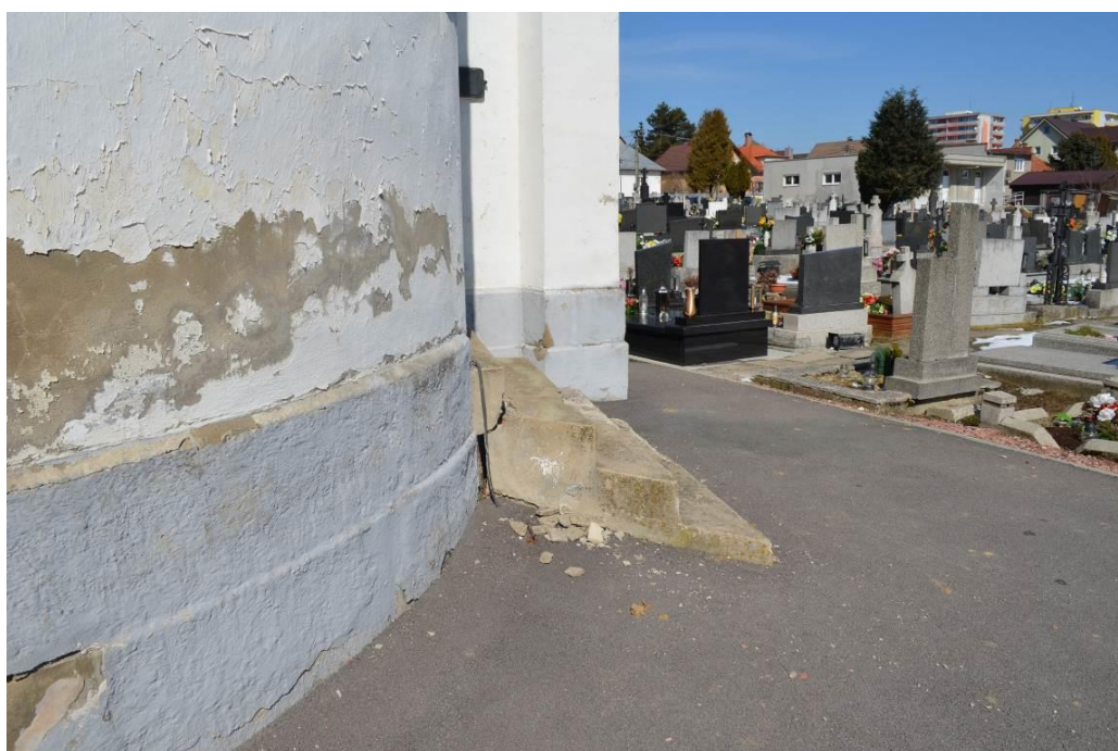
8. Pohľad na dolnú soklovú časť fasád Mauzólea, JV strana (foto: Ďurian, marec 2018)
