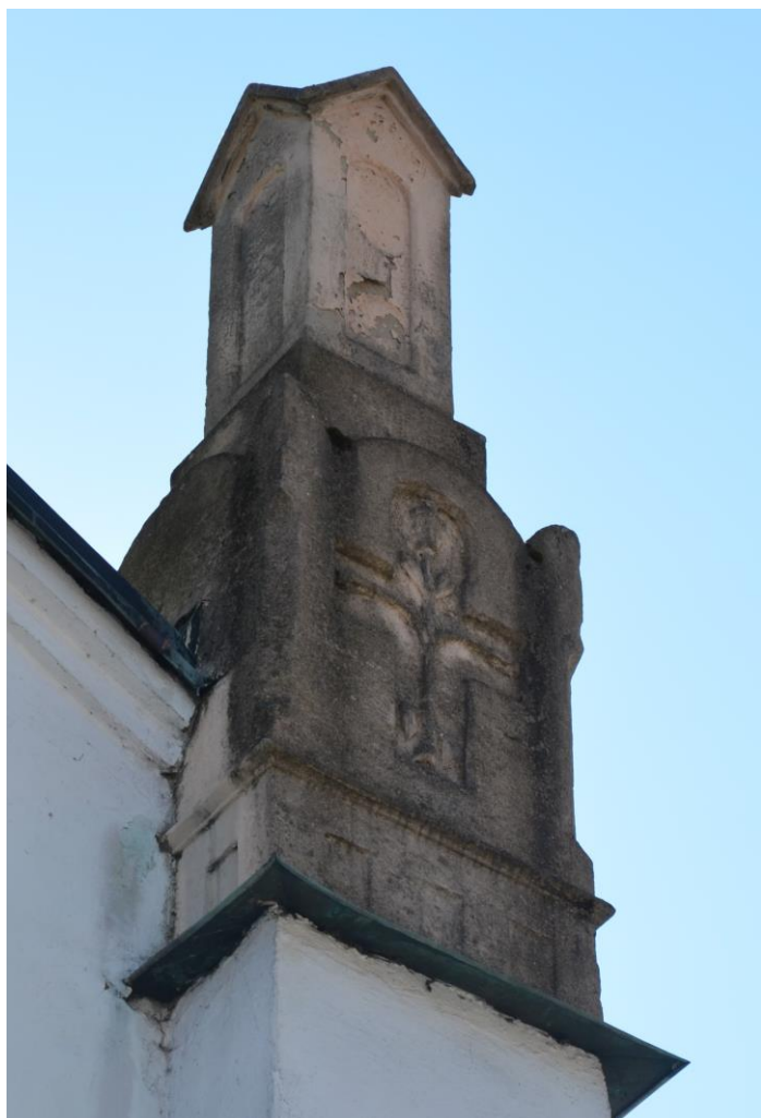
7. Detailný pohľad na dekoratívny kamenný nadstavec operáku s poškodeniami (foto: Piecková, jún 2023)
