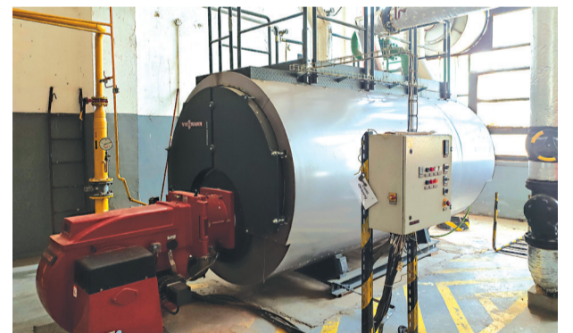
Na mieste plynového kotla PK5 na Brehoch sa nainštalujú nové zariadenia KGJ.
