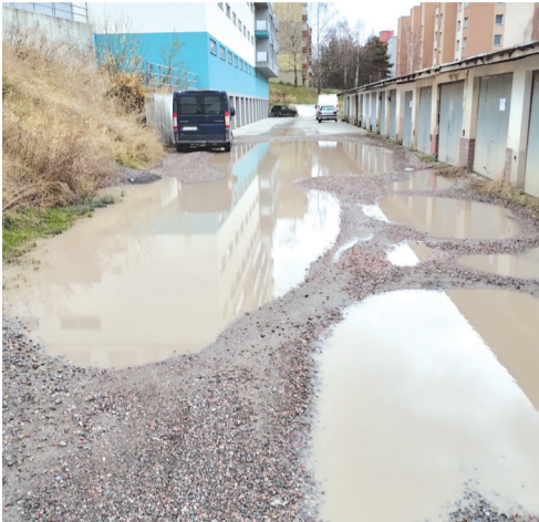
Havarijný stav pri garážach na Brehoch.
